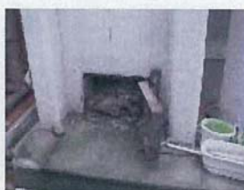
劣化（はく落した断熱材が点検口内に堆積）
